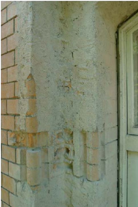
Beschädigte und überputzte Formsteingewände
